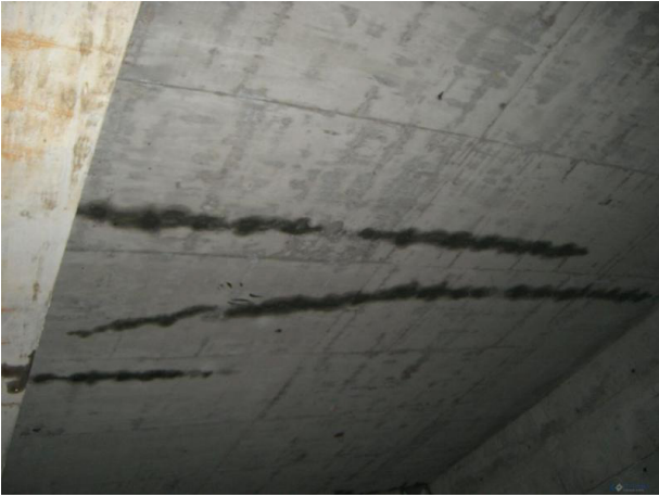
图1 顶板单方向裂缝
